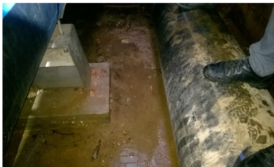
Zdj. 9 – widok zanieczyszczonej posadzki
