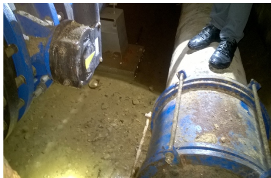
Zdj. 10 – widok zanieczyszczonej posadzki
