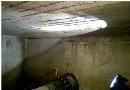
Zdj. 8 - łączenia stropu ze ścianami wymagające uszczelnienia
