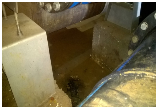
Zdj. 11 - widok zanieczyszczonej posadzki
