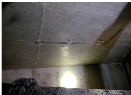
Zdj. 2 Strop – powierzchnia częściowo rozkruszona otulina dolna prętów – do naprawy
