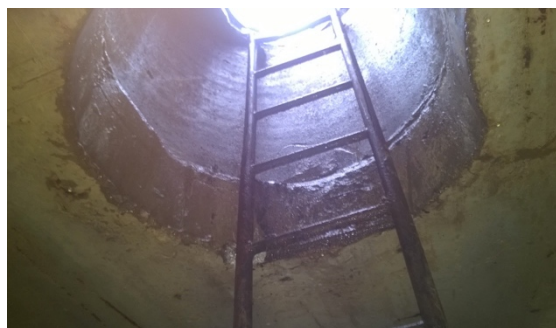
Zdj. 12 – widok włazu – do wymiany i uszczelnienia
